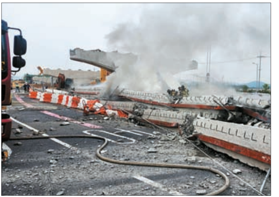
시흥 교량 공사 중 상판 붕괴 - 7명 부상 30일 오후 4시30분경 경기도 시흥시 월곶동 서해안로 부근 고가차로 건설 현장에서 교량 상판이 붕괴하는 사고가 발생했다. 이 사고로 공사 관계자 6명과 시민 1명 등 총 7명이 다쳤다. 이날 소방관들이 현장을 수색하고 있다. [사진 경기소방재난본부]
