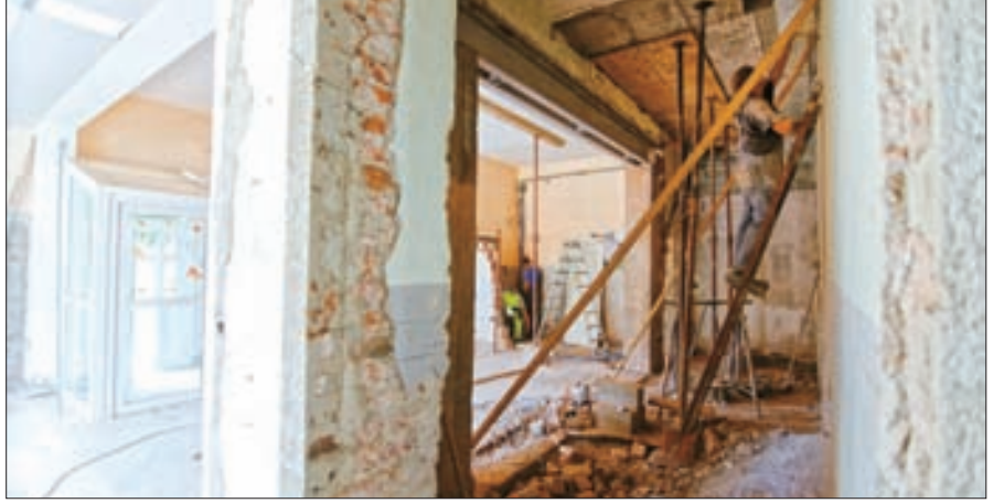
물이 새는 지붕이나 벽을 장기간 방치하면 곰팡이가 급속도로 확산돼 주택 피해는 물론 호흡기질환 위험도 있으므로 점검을 받고 가능한 빨리 수리해야 안전하다. (unsplash.com 제공)
