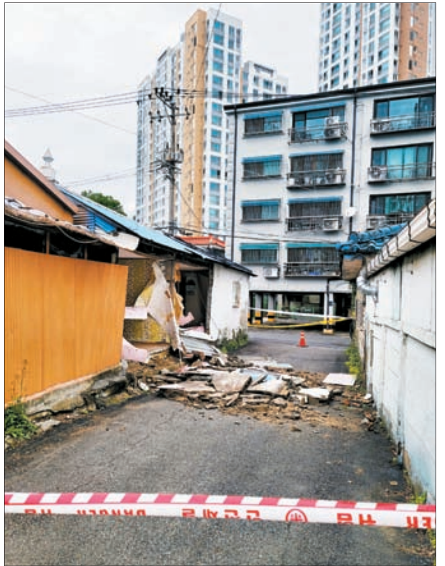
경기도 용인시 김량지역 인근 빌라촌의 빈집. 외벽이 무너져내린 채로 방치돼 있다. 빈집이 늘면 마을의 슬럼화가 진행하면서 주거환경은 열악해지고, 주변 지역의 집값은 내려간다. 용인=김원 기자
