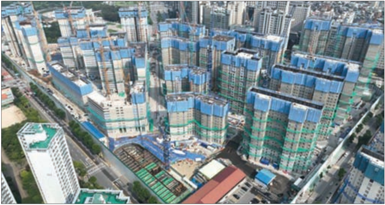
하반기에 분양가상한제를 적용받아 주변 시세보다 3.3㎡당 2000만원 정도 저렴하게 분양할 예정인 서울 송파구 신천동 잠실진주 재건축 아파트. 이미 2021년말 착공했고 내년 말 준공 예정이다. [사진 삼성물산]
